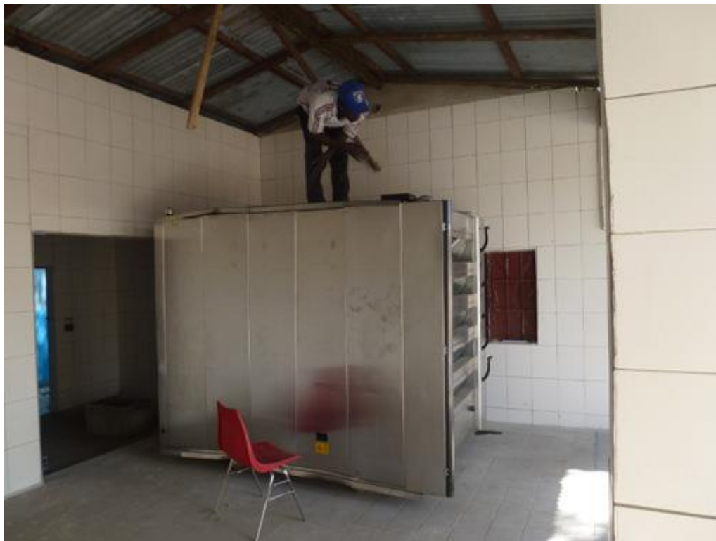
Da steht er, der grosse Backofen.
